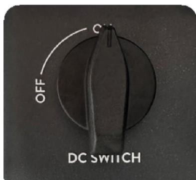
Slika 17: Izklop enosmernega toka izfotovoltaičnega sistema_1.1
