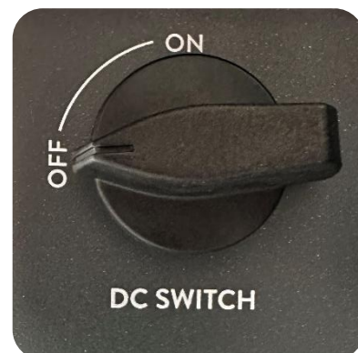
Abbildung 18: Deaktivierung der PV Gleichstromversorgung_1.2
