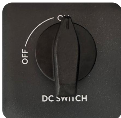
Abbildung 17: Deaktivierung der PV Gleichstromversorgung_1.1
