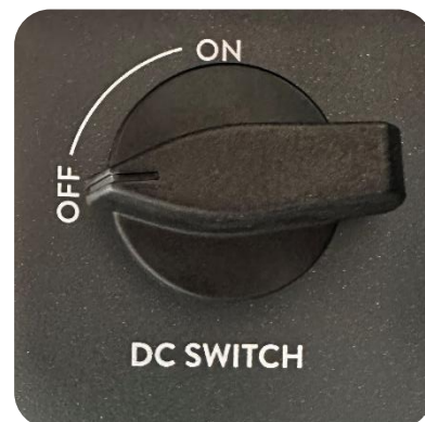
Abbildung 18: Deaktivierung der PV Gleichstromversorgung_1.2
