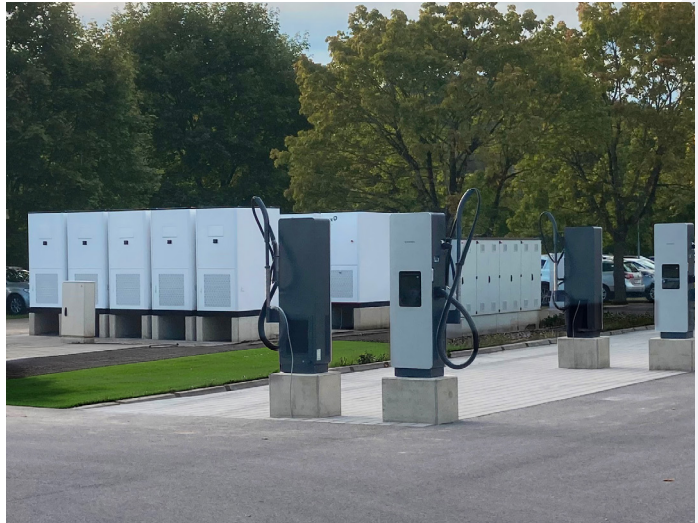
EV-LADEPLATZ MIT INTEGRIERTEN G-MAX-BATTERIEN
